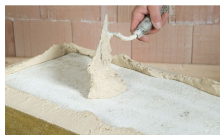
Lepenie minerálnovláknitých dosiek s uzavretou okrajovou húsenicou a bodovým lepením (SMARTwall, FKD S Thermal).
